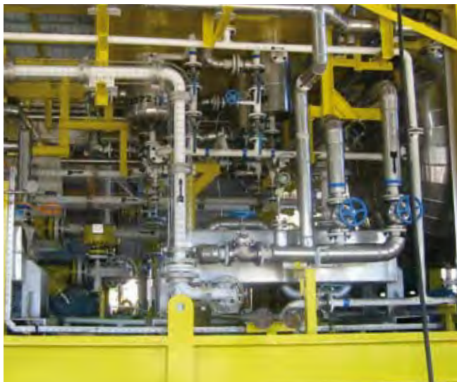
Цельно сварные теплообменники Трантер на морской платформе.
