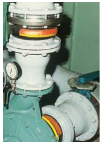
Использование компенсатора типа AR-1 фирмы СТЕНФЛЕКС в насосной системе
