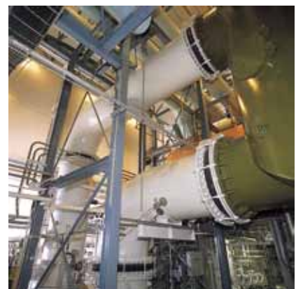
Компенсатор типа С-31 фирмы СТЕНФЛЕКС на электростанции
