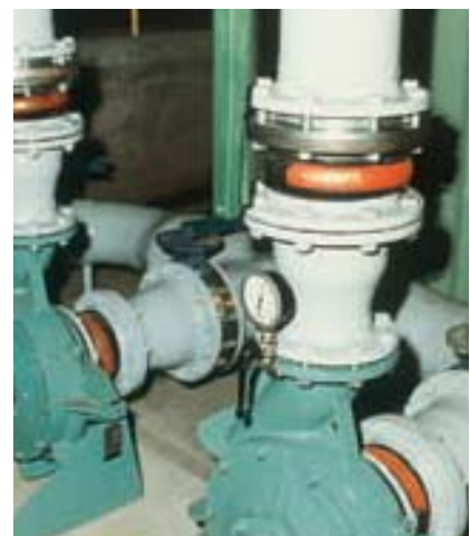
Использование компенсатора типа А-1 фирмы СТЕНФЛЕКС в насосной системе
