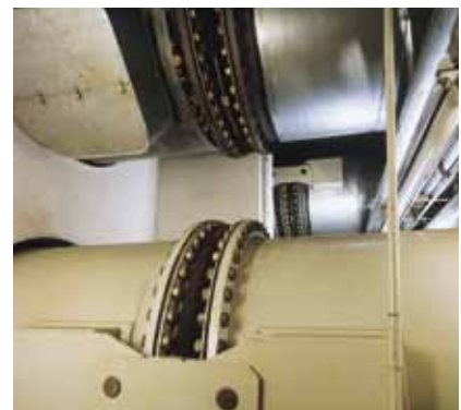
Компенсатор типа С-1 фирмы СТЕНФЛЕКС со специальной шарнирной затяжкой в системе циркуляции охлаждающей жидкости на электростанции
