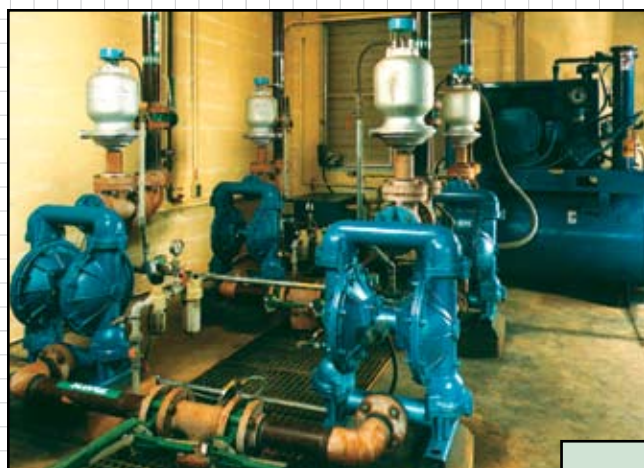
Стационарные стандартные металлические насосы, установленные внутри помещения в качестве откачивающих насосов в химической промышленности.
